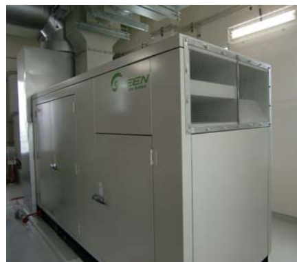
－ 自家発電設備 －
