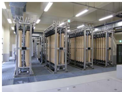
－膜ろ過処理装置－
